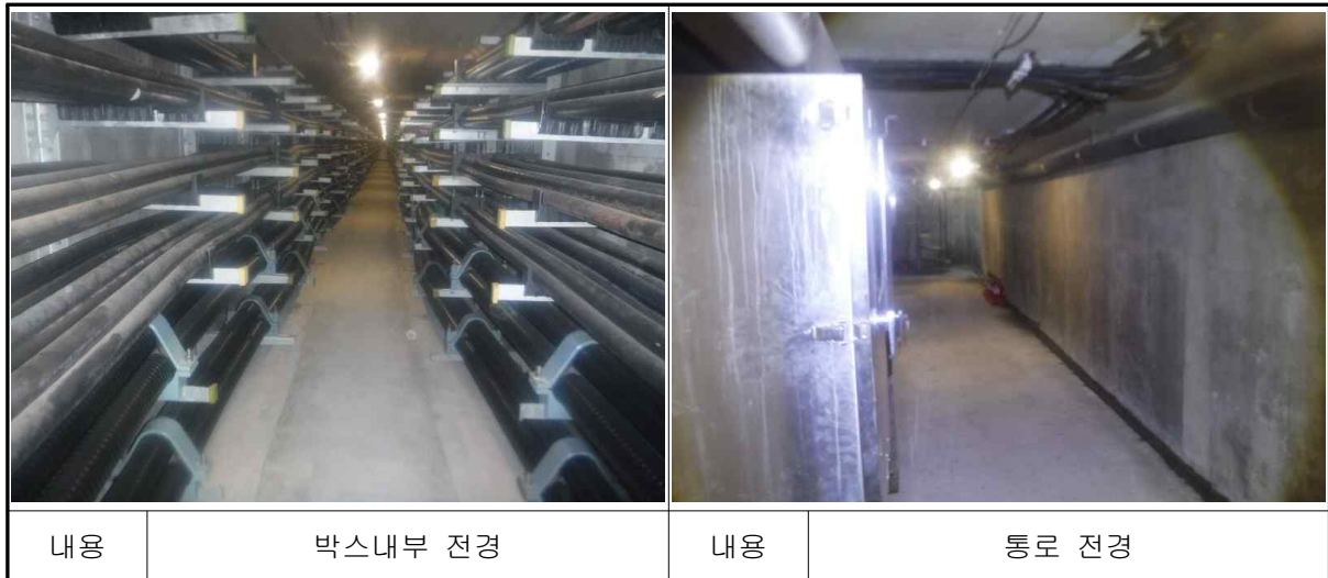
【사진 2.1】 별내인출 전력구 현황
